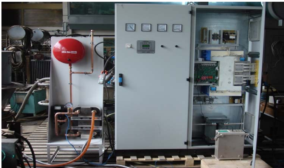
Fig. 2.2. Vedere frontală a sistemului.
